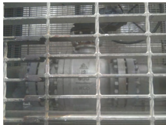
图4 AFA的C型耐磨球阀在宁波万华黑水、灰水管线上的应用
