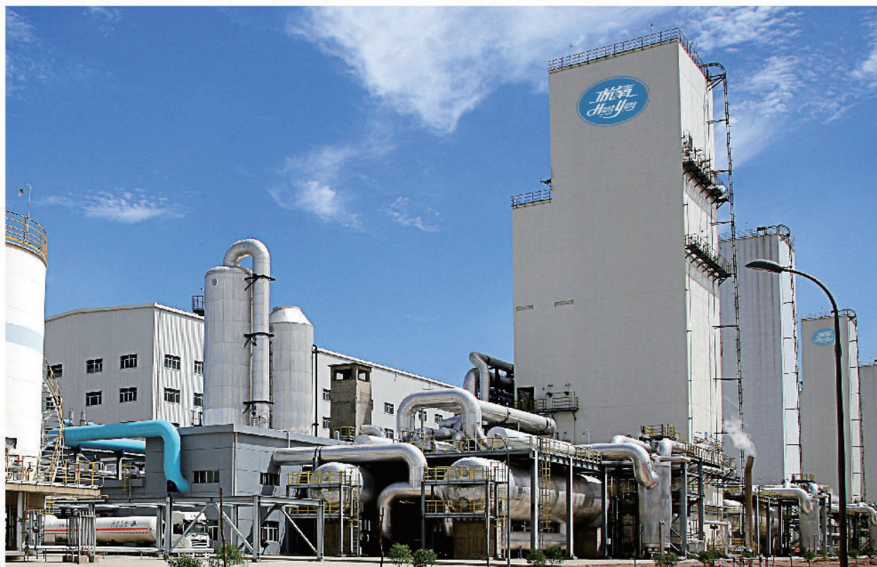
空气分离设备 Air Separation Unit
